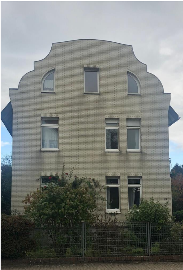
Vor der Sanierung war das Haus an der Willicher Straße nicht sehr ansehnlich. Die Fassade war mit Klinkern verkleidet.
